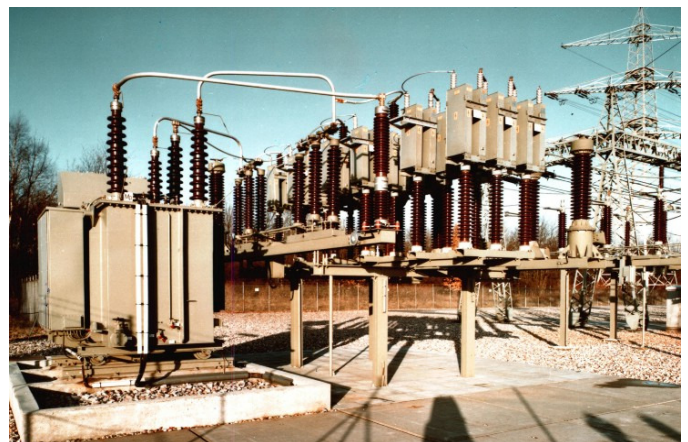
RAP für Hochspannung (Freiluft)
